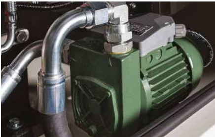
Bomba de trasiego de combustible
